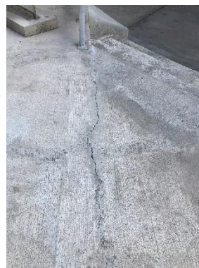
Foto N°18: Fisuras en pavimentos interiores del estadio
