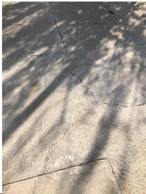
Foto N°21: Fisuras en pavimentos interiores del estadio
