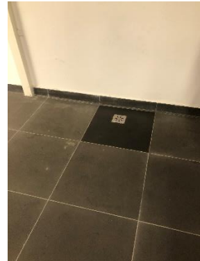
Foto N°26: Se ejecutó el sumidero sin pendientes, y a un costado de cada recinto de camarín.
