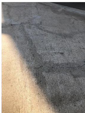
Foto N°17: Fisuras en pavimentos interiores del estadio
