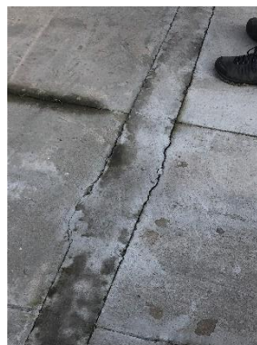
Foto N°20: Fisuras y desconches en juntas, en pavimentos interiores del estadio.
