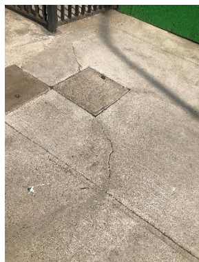
Foto N°19: Fisuras y desconches en juntas, en pavimentos interiores del estadio.
