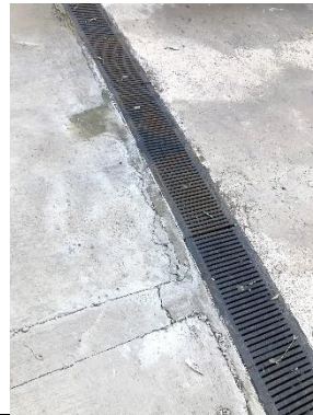
Foto N°22: Fisuras y desconches en juntas, en pavimentos interiores del estadio.
