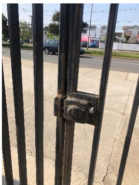
Foto N°15: Presencia de corrosión en perfiles metálicos de portones.
