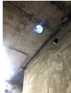
Foto N°24: Ventilación desprovista de protección ante las aguas lluvias.
