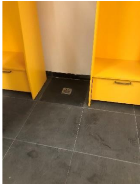
Foto N°25: Se ejecutó el sumidero sin pendientes, y a un costado de cada recinto de camarín.
